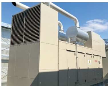
▲ 非常用自家発電機
